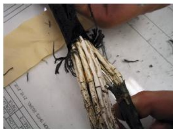
Corroded wire bundles. Корродированные жгуты проводов
