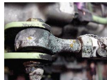
Corroded control connectors. Корродированные разъемы управления
